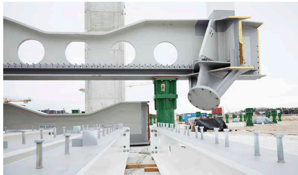
Hauptträger 1. OG mit geschweißter Stahlschwertkonstruktion für den Anschluß der V-förmigen Stahlverbundstütze. Main girder of the second floor with welded steel strut construction for the connection of the v-shaped steel and concrete supports.
